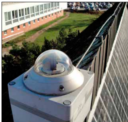
Bild 3: Sensor für die Messung der direkten Sonnenstrahlung auf dem Giebel des Solarhauses
